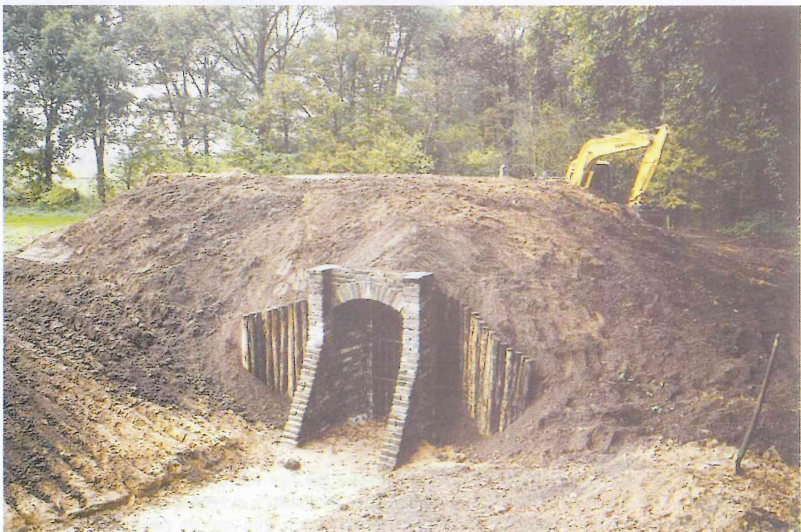
De bouw is grotendeels gereed. Er wordt een flinke laag zand overheen gebracht. Zie voor het eindresultaat de foto op de voorpagina. Foto: Roel Winters.
